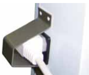
Kuva 10. Karmivastuksen kaapeli ja suojus
