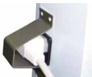
Photo 10. Protection de la prise du chauffage de cadre de porte
