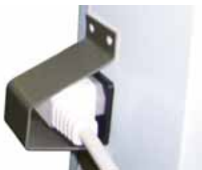
Kuva 10. Karmivastuksen kaapeli ja suojus
